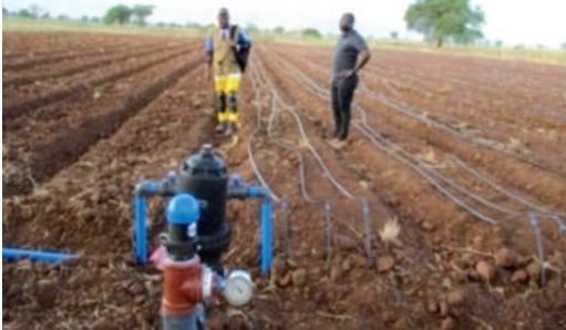
Système d'irrigation à énergie solaire
