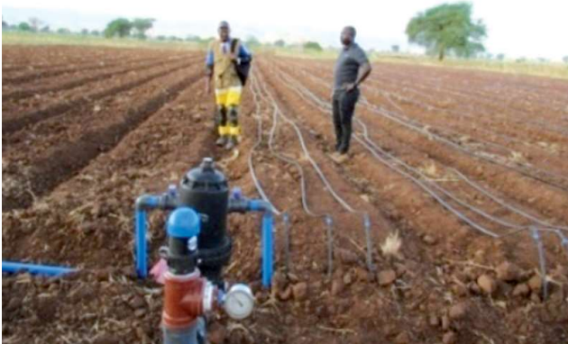
Système d'irrigation à énergie solaire
